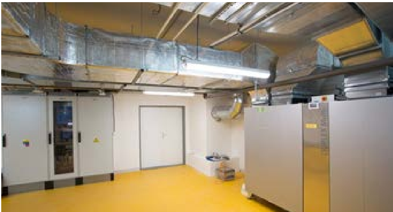
Obrázok 8: Technická miestnosť (zdroj: https://partnerskadohoda.gov.sk )
