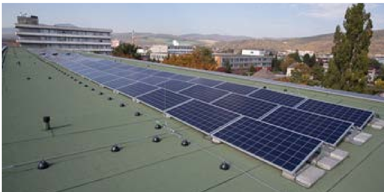
Obrázok 7: Inštalácia fotovoltaiiky (zdroj: https://partnerskadohoda.gov.sk )
