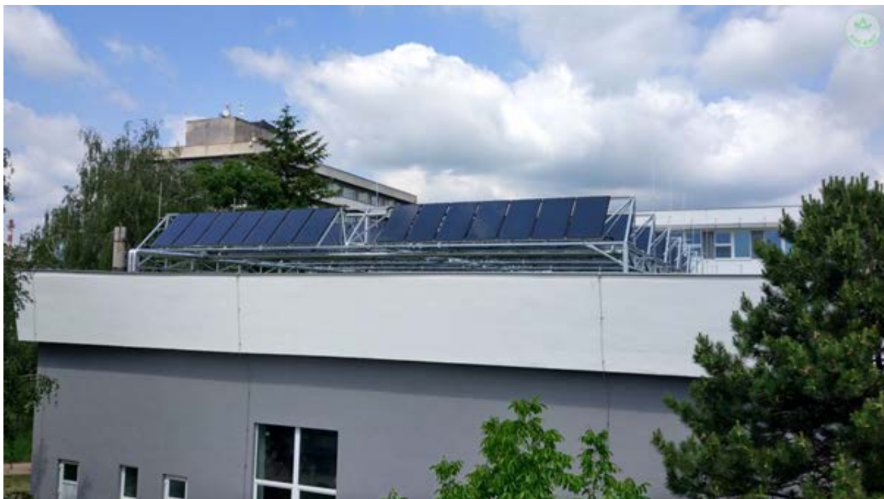
Obrázok 6: Fototermické panely na streche bazéna (zdroj: https://partnerskadohoda.gov.sk )
