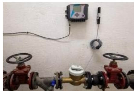
Obrázok 13: IoT senzory inštalované k fakturačným odberným miestam (zdroj: https://automatizace.hw.cz/vyuziti-technologie-iot-pro-energeticky-management-budov.html )
