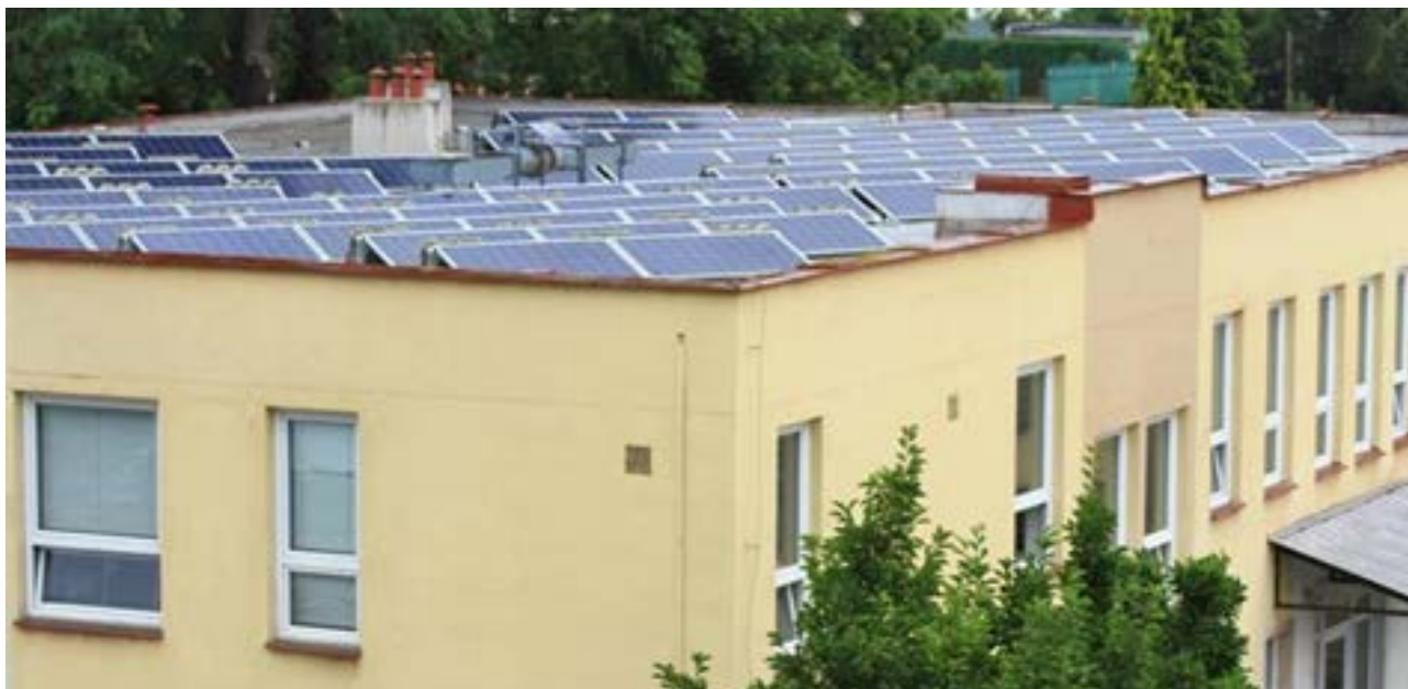
Obrázek 14: Střešní instalace (zdroj: PORSENNA o.p.s.)
