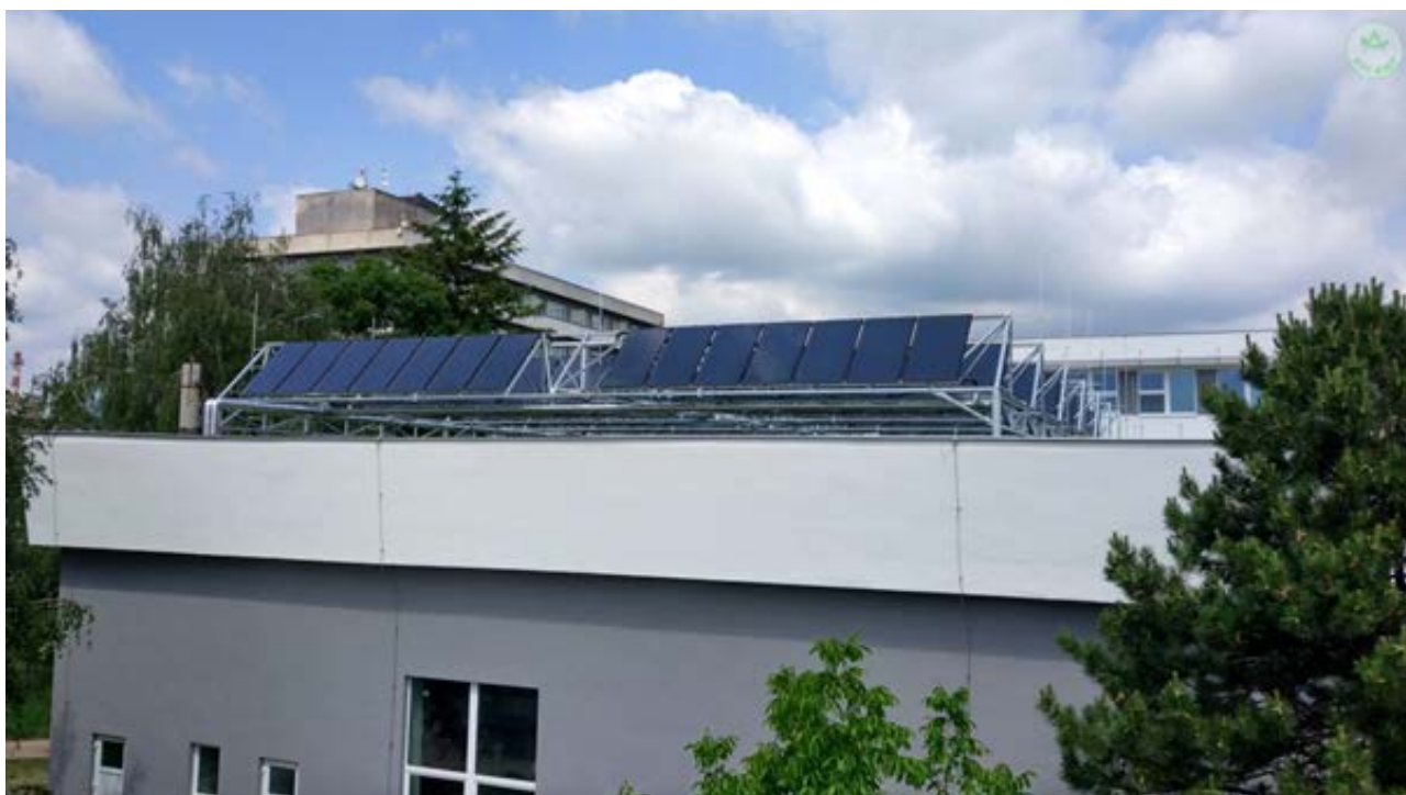
Obrázek 6: Fototermické panely na střeše bazénu (zdroj: https://partnerskadohoda.gov.sk )
